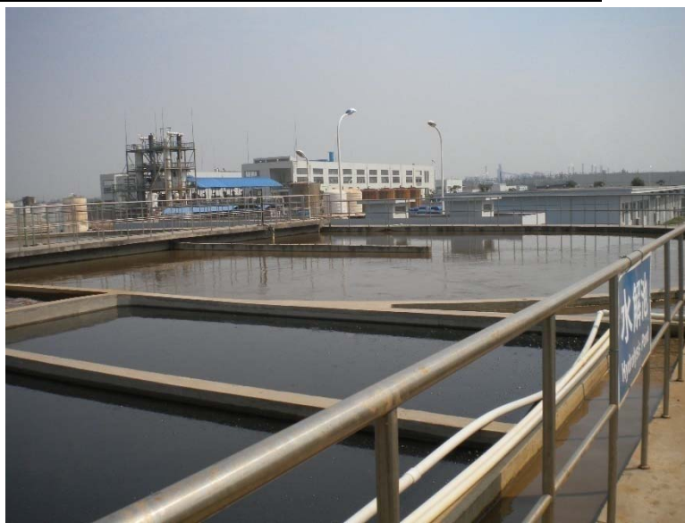
图 7.2-11 江苏巨邦医药集团制药废水处理工程
